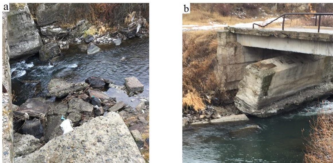
Рис. 1. Разрушенная опора моста: а) вид с верхнего бьефа; б) вид с нижнего бьефа Fig. 1. Destroyed support of the bridge: a) view from upstream; b) view from downstream
