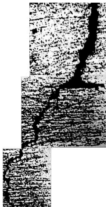
Рисунок 6 - Стресс–коррозионная трещина, образовавшаяся в процессе эксплуатации катодно – защищаемого трубопровода
