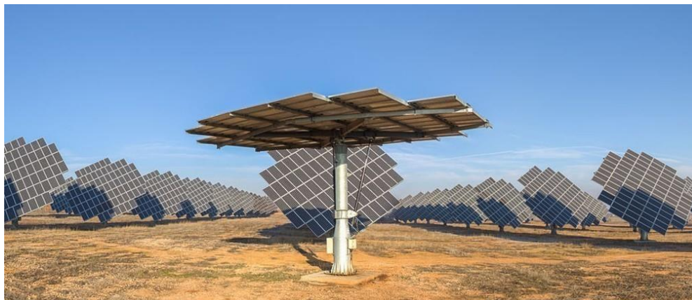
Рис. 6 Солнечная электростанция, которая может отслеживать солнце
