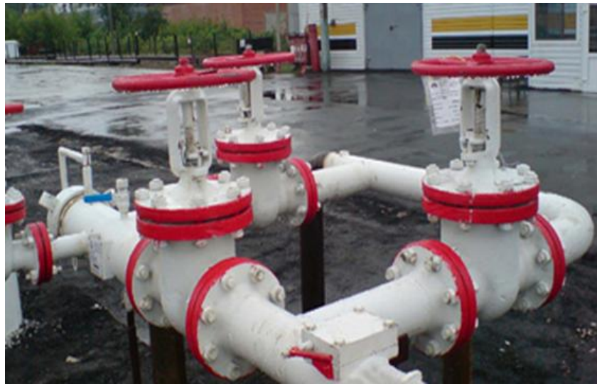
Рисунок 19 - Камера приема шара в напорном трубопроводе (КПШ)
