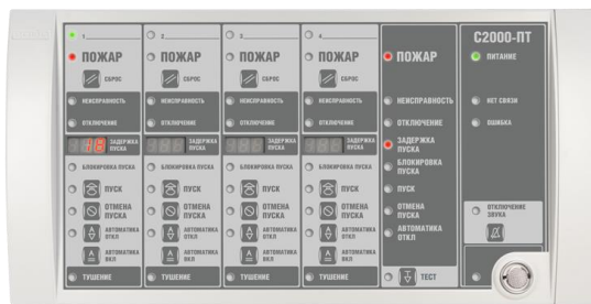
Рисунок 6 – Блок индикации системы пожаротушения «С2000-ПТ»
