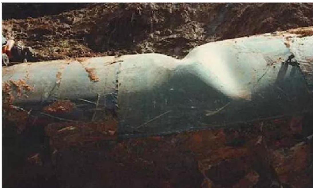
Рисунок 1 – дефект трубопровода в виде гофры
