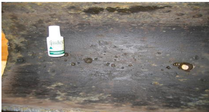
Рисунок 10 – Характер питтинговой коррозии нефтесборного трубопровода
