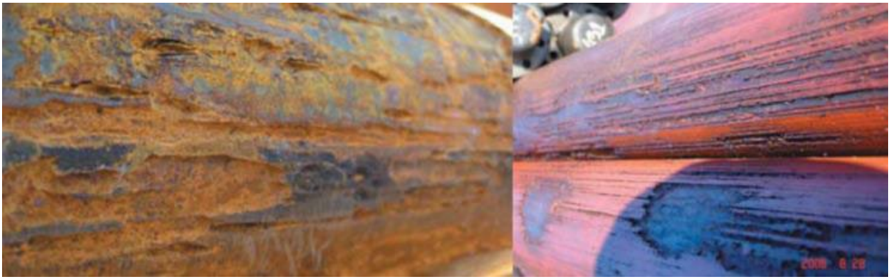
Рисунок 3 – Коррозия в виде бороздок
