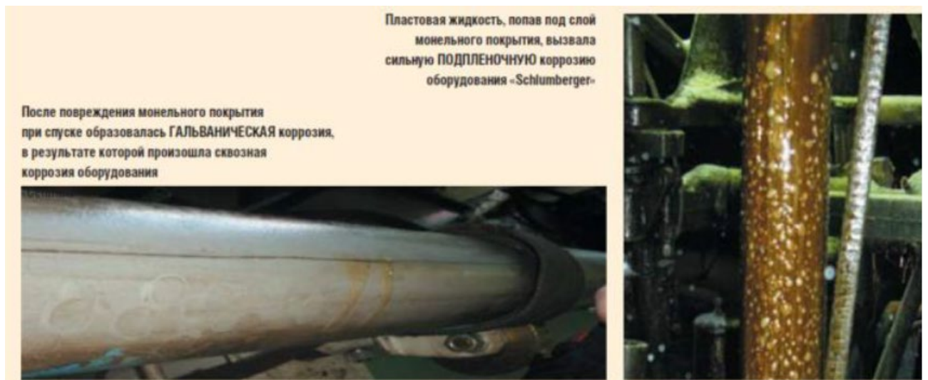
Рисунок 6 – Подпленочная (справа), гальваническая (слева) коррозии
