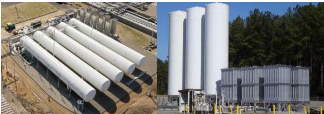
Рисунок 8 – Вертикальные криогенные резервуары с системой регазификации [23]
