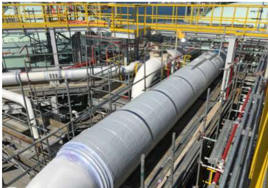
Рисунок 8 – Междоцеховой криогенный (низкотемпературный) трубопровод [29]
