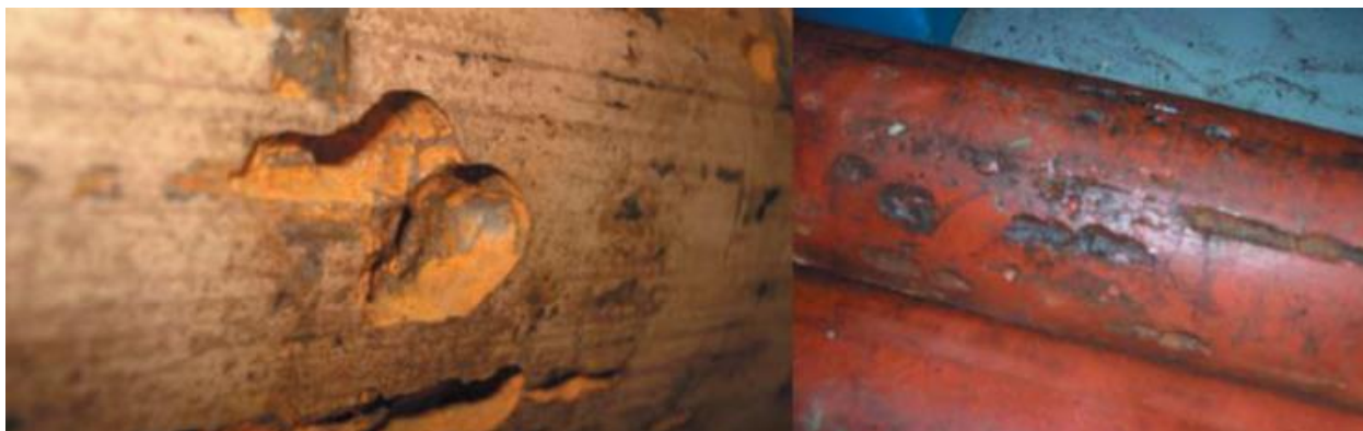
Рисунок 1- Питтинговая (язвенная коррозия)
