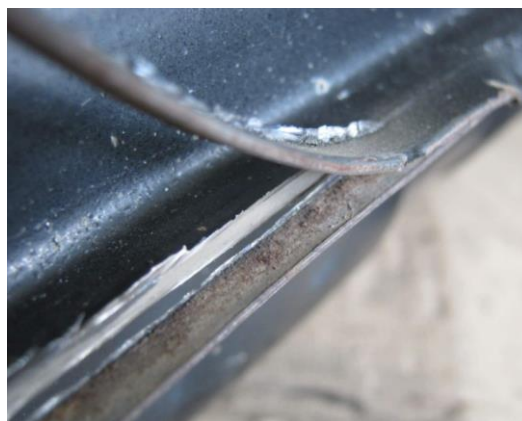
Рисунок 16 – Пример щелевой коррозии
