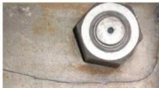
Рисунок 9 – Коррозия под напряжением, коррозионное растрескивание
