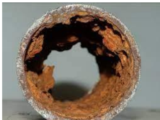
Рисунок 4 – Пример газовой коррозии
