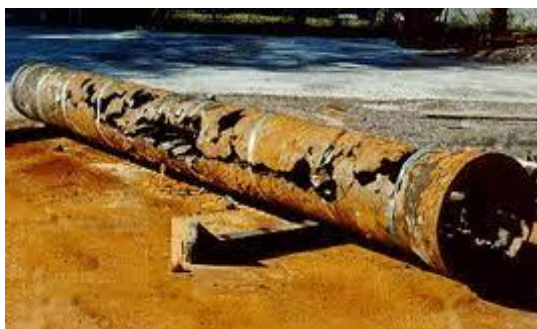
Рисунок 5 – Пример подземной коррозии
