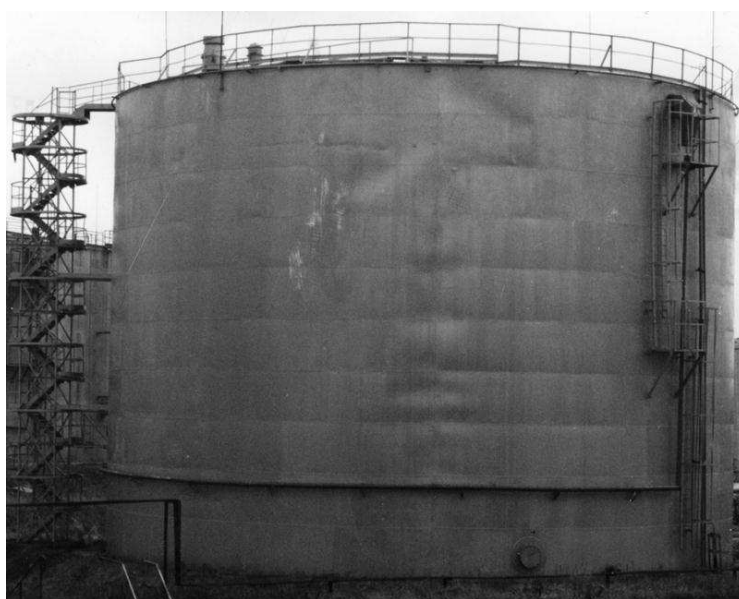
Рисунок 1 – Дефект геометрии стенки РВС типа вмятин
