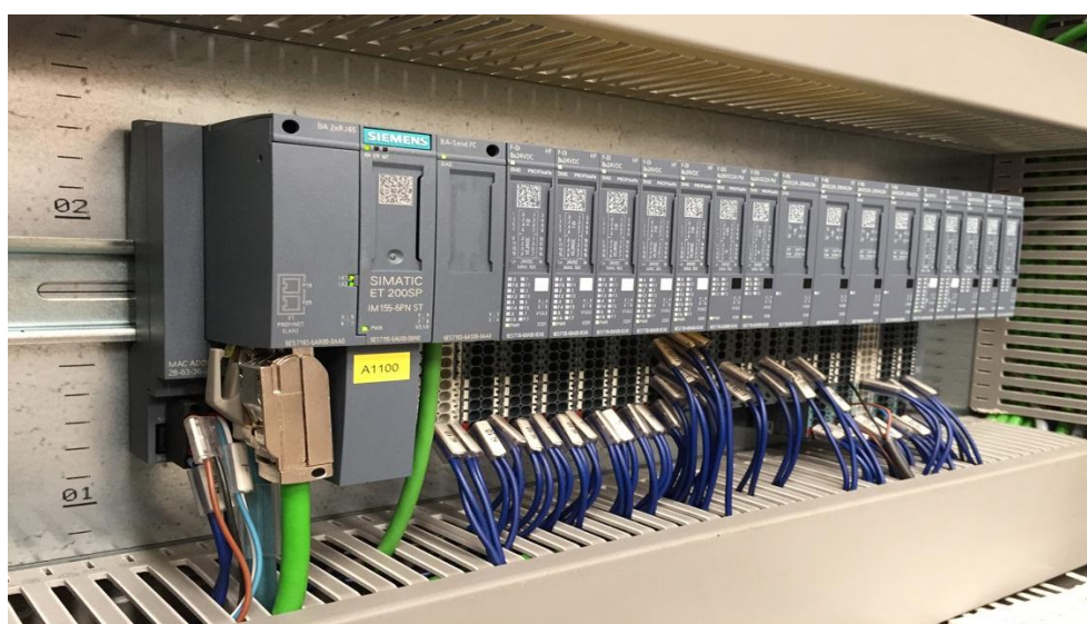
Рисунок 22 – Установленная в шкафу распределенная система ввода-вывода ET 200 SP
