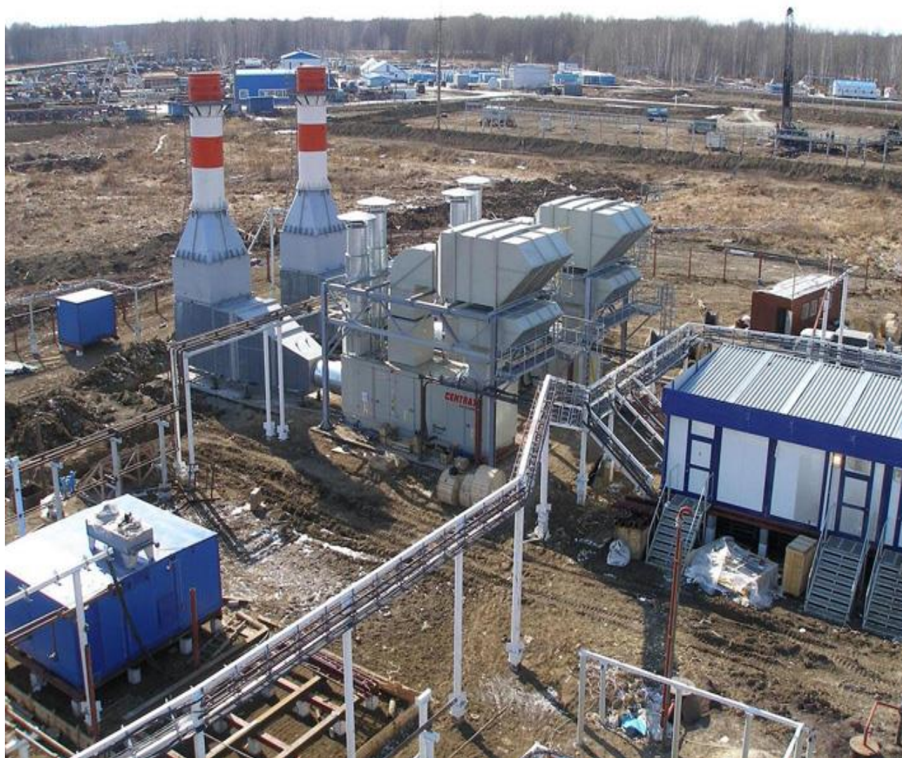
Рисунок 10 – Газотурбинная установка «Сентрах» CX 501-KB7 с турбиной «Rolls-Royce» 501KB7 на Верх-Тарском месторождении
