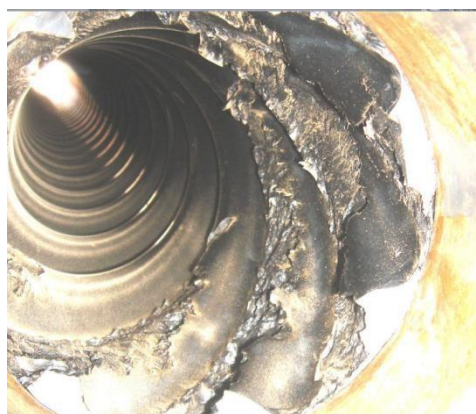
Рисунок 44 – Вид обкладки статора после вырывания резины
