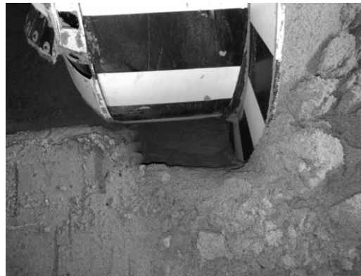
Рис. 5. Разрушение опорного участка геосреды возле ВД
