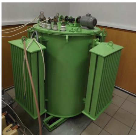
Рисунок 4.19 – Регулировочный трансформатор РОТМ-100/0,5
