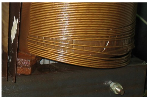
Рисунок 13 – Внешний вид обмотки ВН с дефектом типа «аксиальное смещение витков»
