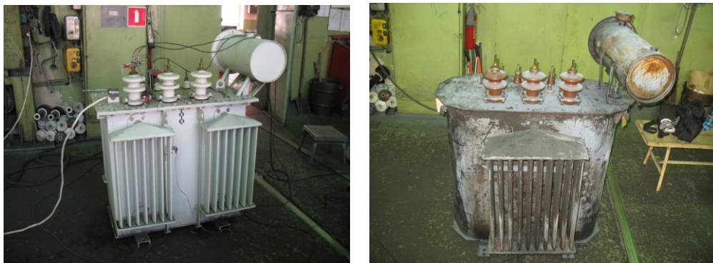
Рисунок 8 – Внешний вид исправного трансформатора (слева) и трансформатора с обмотками в дефектном состоянии (справа)
