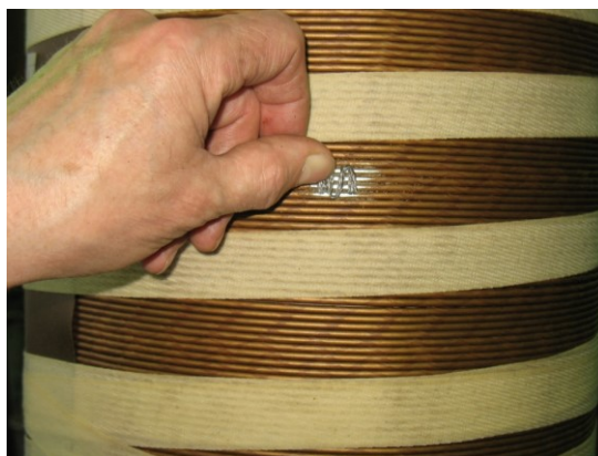
Рисунок 10 – Дефект типа «межвитковое короткое замыкание» на обмотке ВН фазы С
