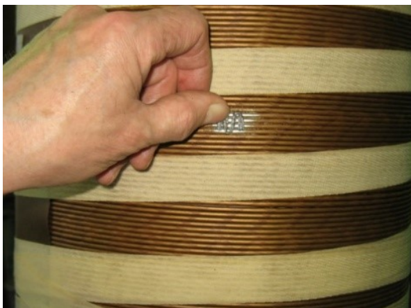
Рисунок 4.4 – Дефект типа «межвитковое короткое замыкание» на обмотке ВН фазы С
