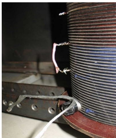
Рисунок 2.38 – Внешний вид части обмотки ВН на сердечнике с КЗ в конце обмотки
