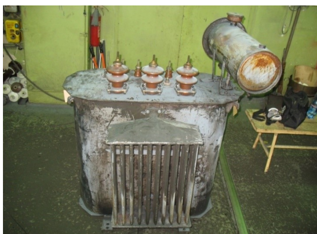
Рисунок 4.2 – Внешний вид трансформатора с дефектными обмотками
