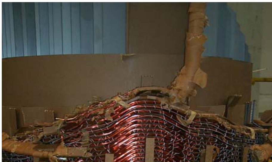
Рисунок 1.15 Фотография дефектной обмотки, соответствующая частотным характеристикам, приведенным на рисунке 1.14
