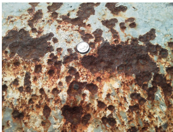
Рисунок № 8- Питтинговая коррозия металла
