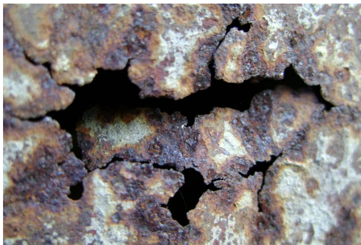
Рисунок № 7– сквозная коррозия металла
