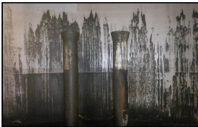
Рисунок 3.1 – Пример повреждения лакокрасочного покрытия, в результате эксплуатации
