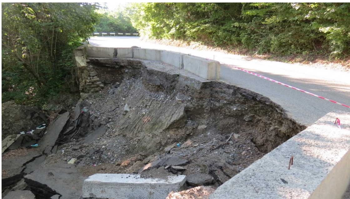
Рисунок 2.5 – Фото обрушения автодороги на участке оползня (ООО «ЦЕНТР-ПРОЕКТ») [1]
