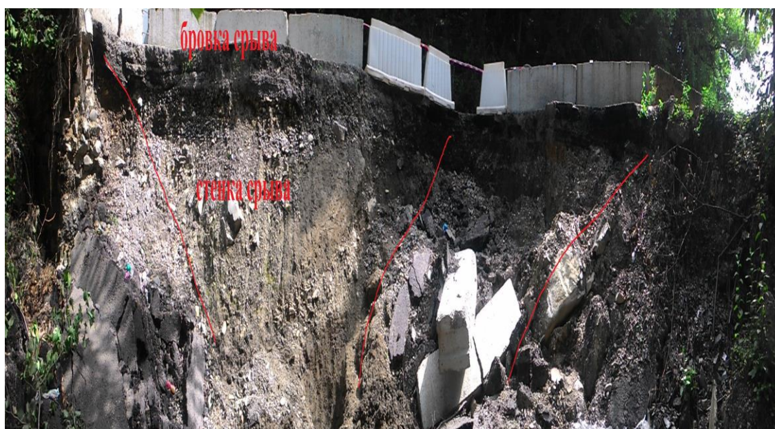
Рисунок 2.6 – Фото оползня, стенка срыва оползня (ООО «ЦЕНТР-ПРОЕКТ») [1]
