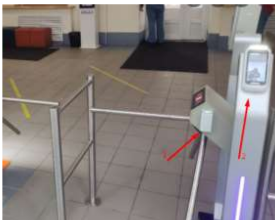
Рисунок 34 - Пример ошибки установки термометра
