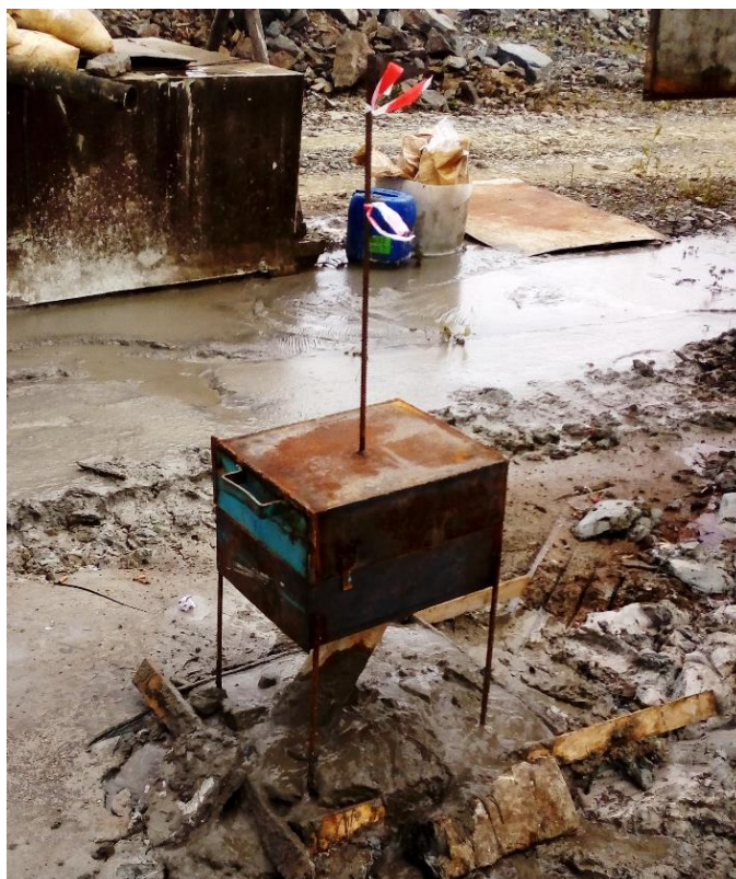
Рисунок 3-18: Установленный над устьем скважины защитный ящик
