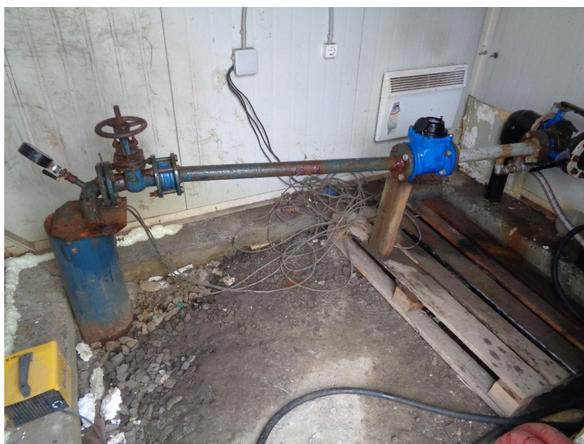
Рис. 2.8 Оборудование устья скважины Б-324 (5)
