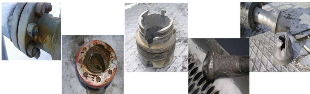
Рисунок 41 – Элементы фонтанной арматуры в результате абразивного износа
