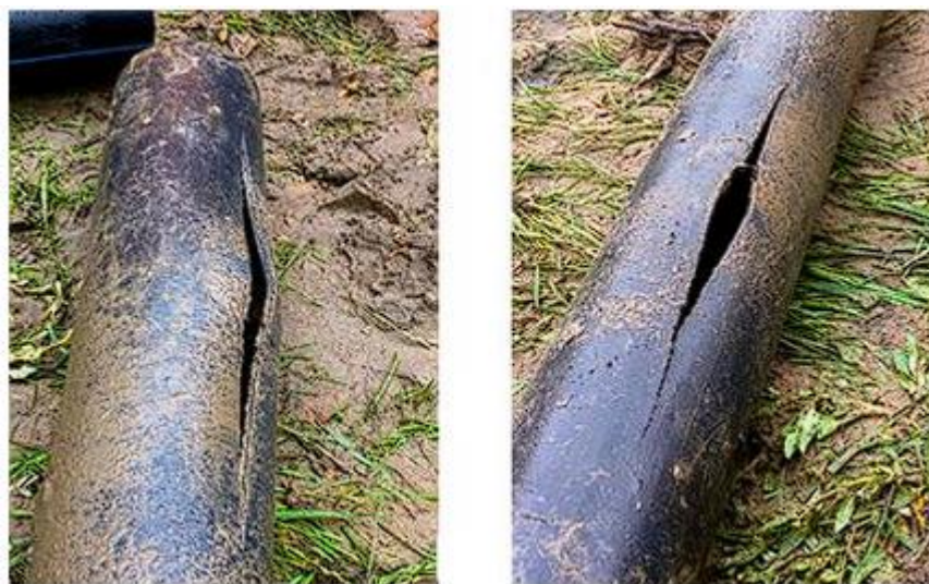
Рисунок 8 – Трещина на трубопроводе
