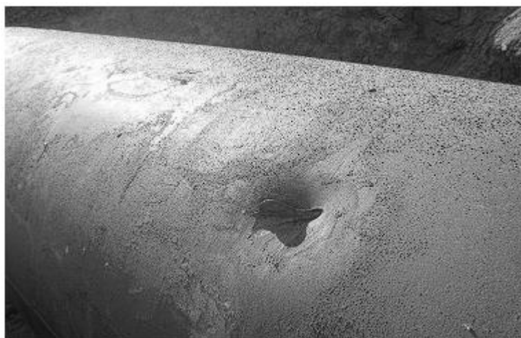
Рисунок 2 – Вмятина на трубопроводе
