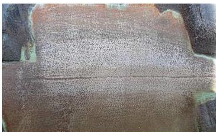
Рисунок 6 – Риска (царапина) на трубопроводе
