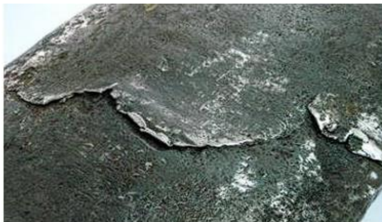
Рисунок 7 – Расслоение на трубопроводе
