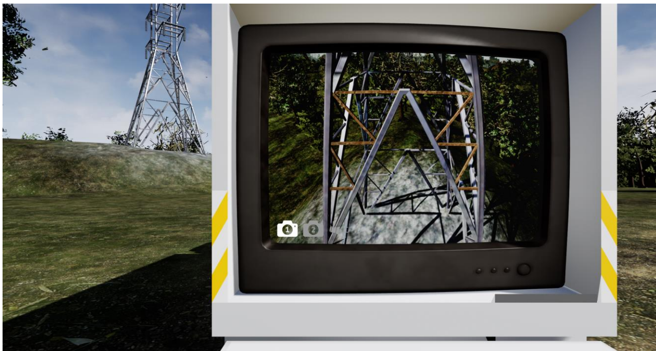
Рисунок 25. Поражённый коррозией элемент опоры ЛЭП
