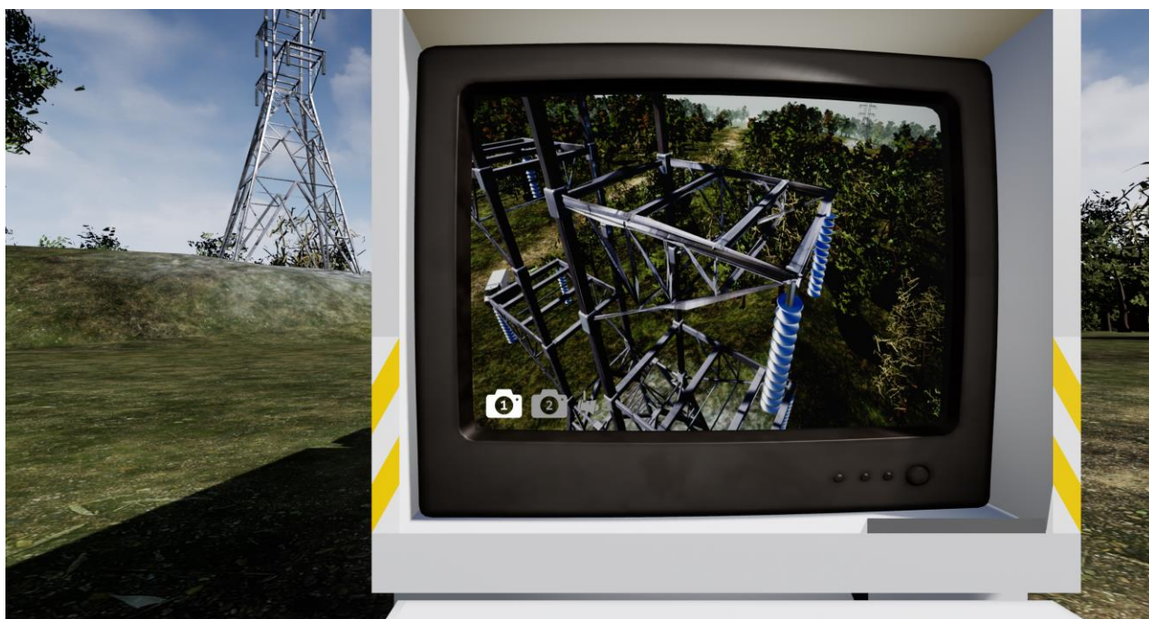
Рисунок 26. Механически повреждённый элемент опоры ЛЭП
