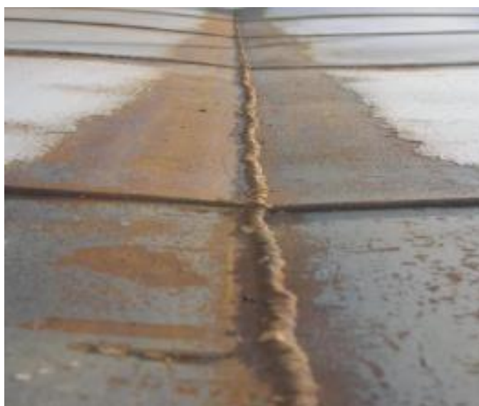
Рисунок 16 – Угловатость монтажного шва
