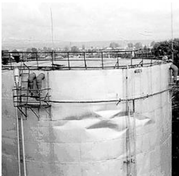
Рисунок 15 – Локальная деформация стенки резервуара
