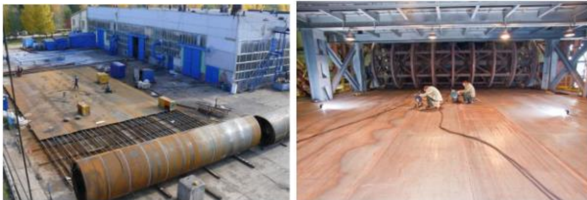
Рисунок 4 – Сборка стенки резервуара из листового полотна в условиях открытой и закрытой площадки
