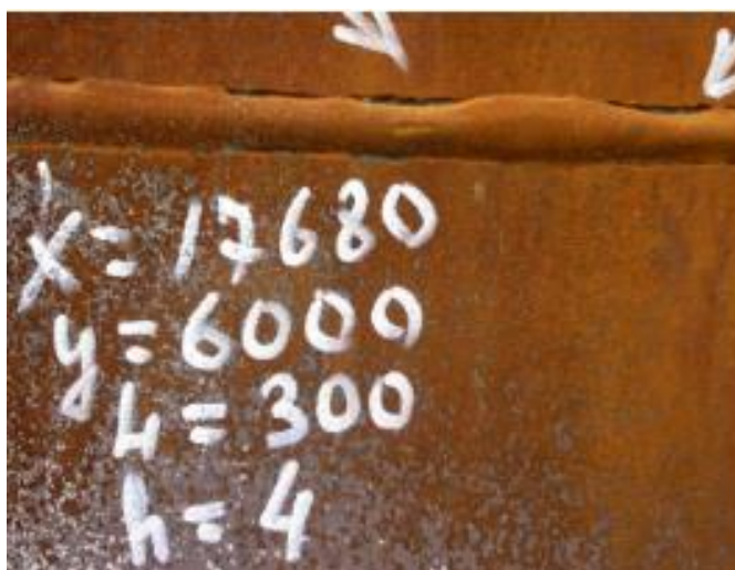
Рисунок 18 – Подрез сварного шва
