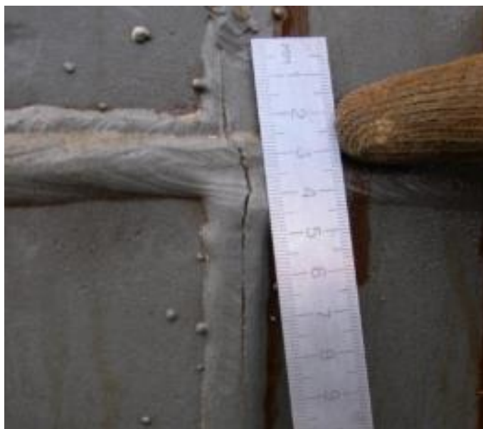
Рисунок 21 – Трещина образованная вдоль сварного шва
