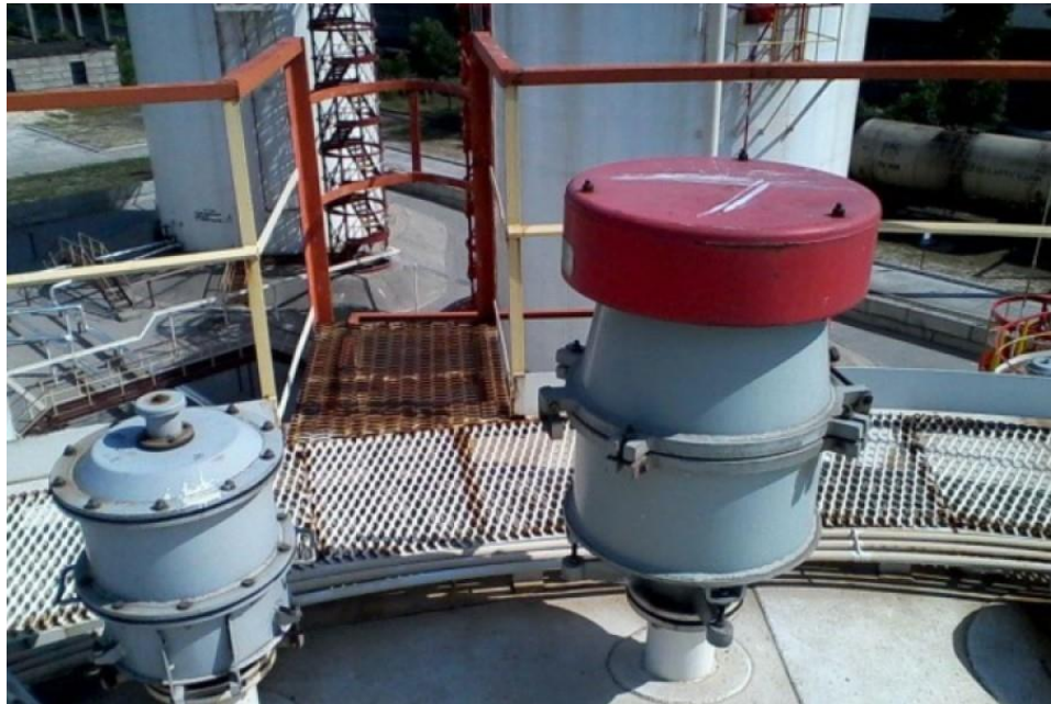
Рисунок 19. Дыхательный клапан, установленный на куполе резервуара
