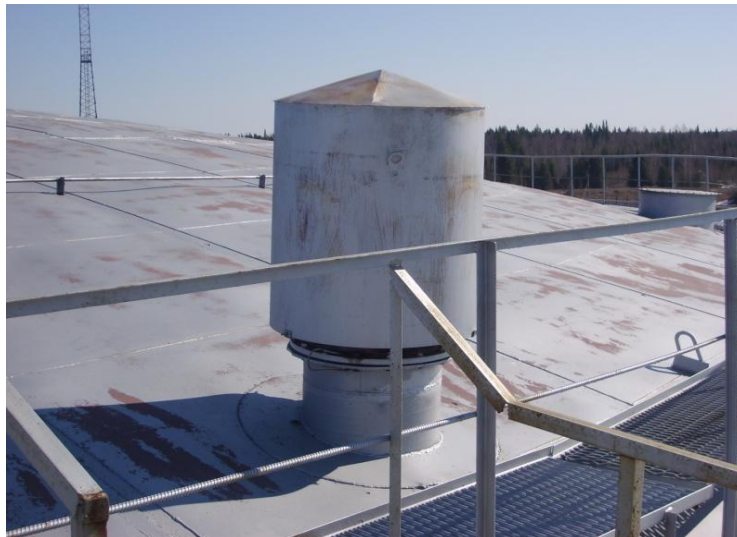
Рисунок 13 – Вентиляционный патрубок ОП-500
