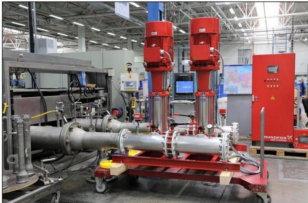
Рисунок 29 – Станция пожаротушения Grundfos Hydro
