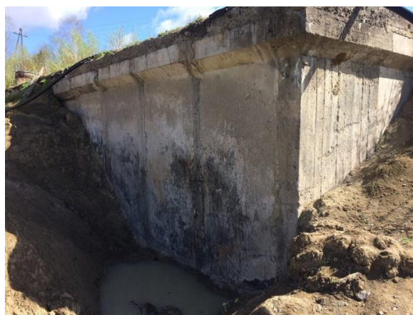
Рис. 6. Разрушение обваловки резервуара Fig. 6. Destruction of the tank embankment
