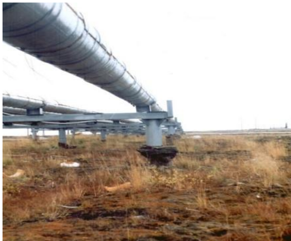
Рис. 1. Морозное выпучивание опор надземного магистрального трубопровода
