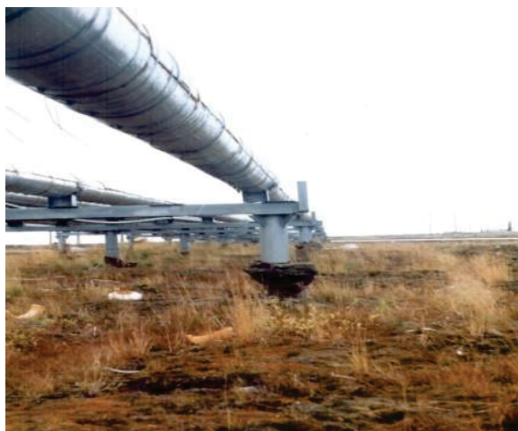
Рис. 1. Морозное выпучивание опор надземного магистрального трубопровода
