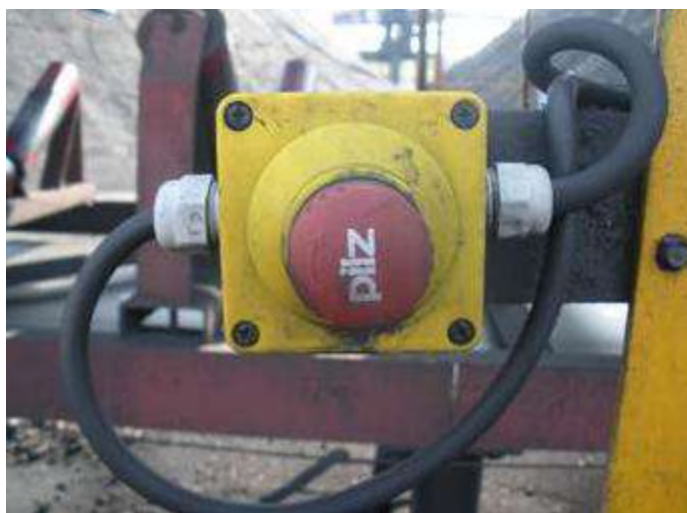
Рис. 1. Кнопка аварийной остановки.
