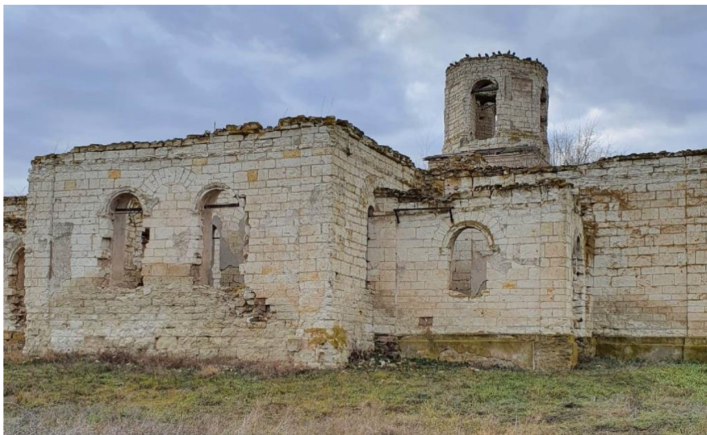
Рис. 6. Разрушенная церковь иконы Божией Матери «Одигитрия» в Ростовской области, сложенная блоками из карбонатных опок
