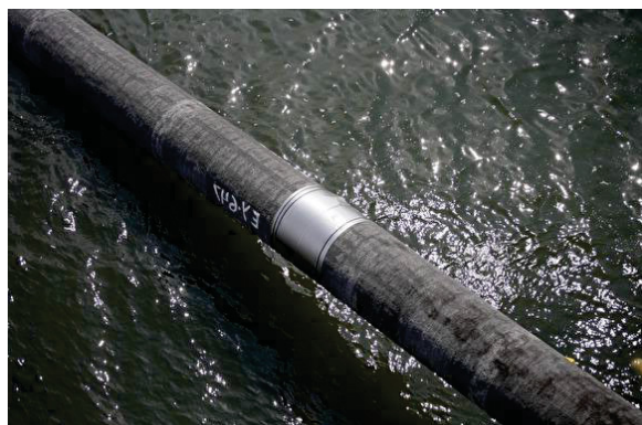
Рис. 1. Размытая оголенная часть подводного участка морского газопровода
