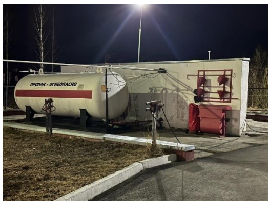
Рисунок 1.3 – Противопожарный щит на АГЗС ООО «Газпром»
