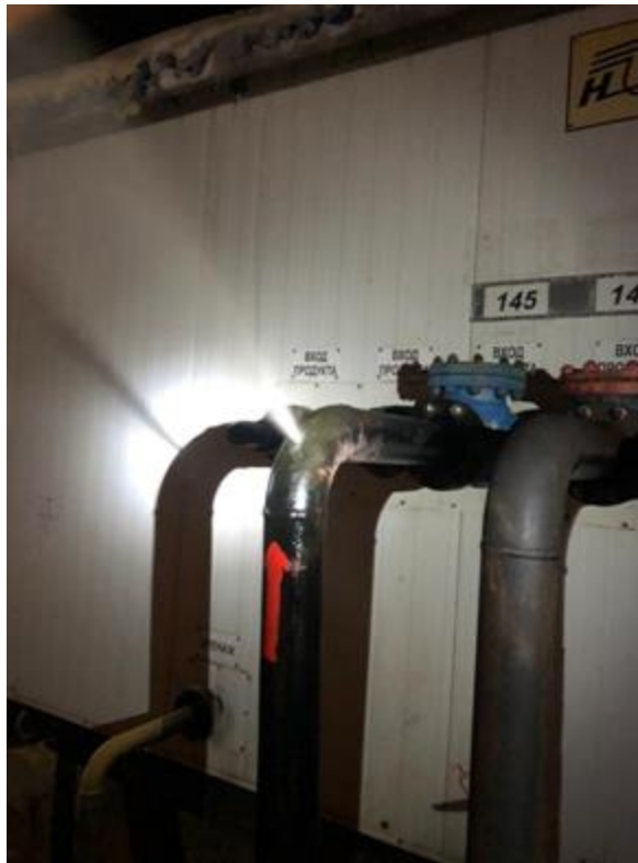
Рисунок 12 – Свищ на выкидной линии перед АГЗУ
