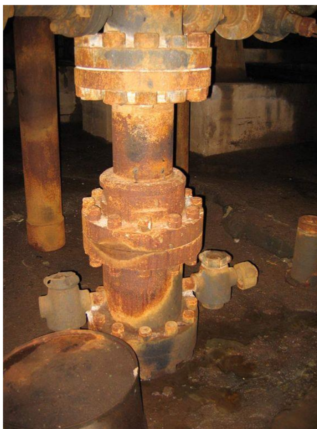
Рис. 2 – Коррозия устьевого оборудования
