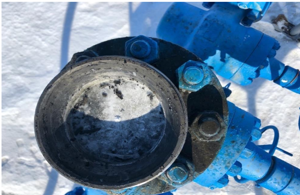
Рисунок 13 – Гидратная пробка на фонтанной арматуре
