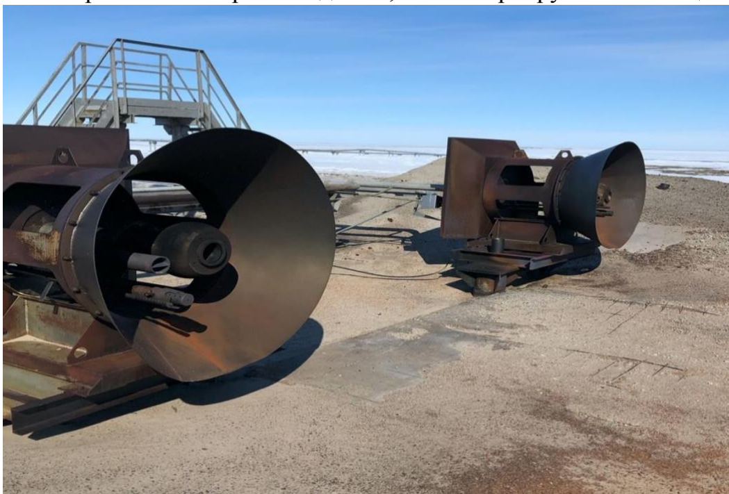
Рисунок 18 – Горизонтальная факельная установка
