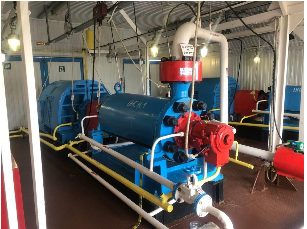
Рисунок 2 – Общий вид БКНС внутри блок-бокса
