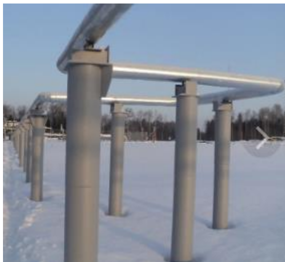
Рисунок 13 – Компенсаторы на трассе межпромысловый нефтепровода Термокомпенсационные блоки, устанавливаемые прямо на опорах,
