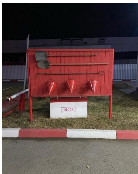
Рисунок 3.3 - Пожарный щит и ящик с песком
