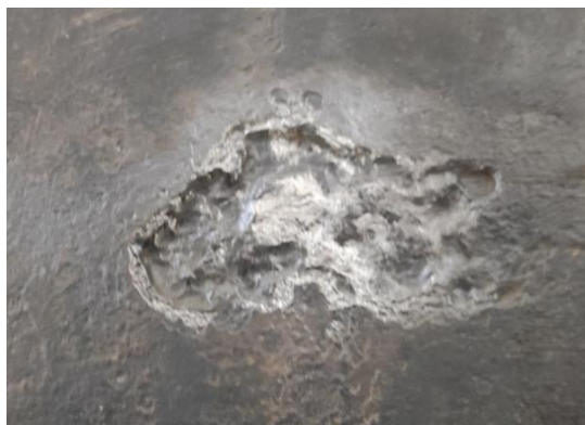
Рисунок 5.2 – Дефект потери металла в результате коррозии
