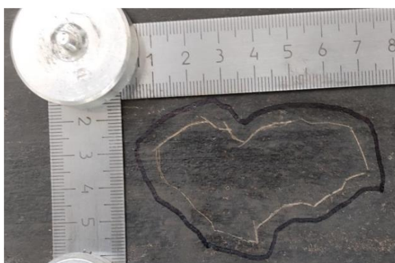
Рисунок 5.3 – Контур дефекта на внутренней стороне
