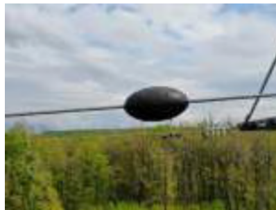
Рис. 2. Датчик СМГ установленный на провод ВЛ
