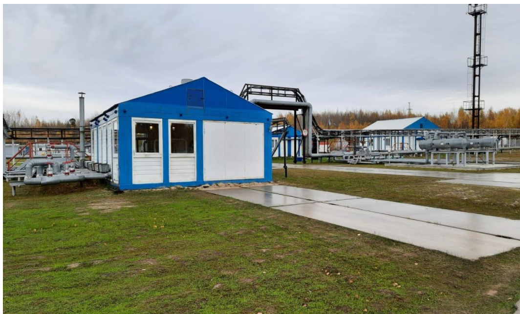
Рисунок 2 – Насосная станция ПСП
