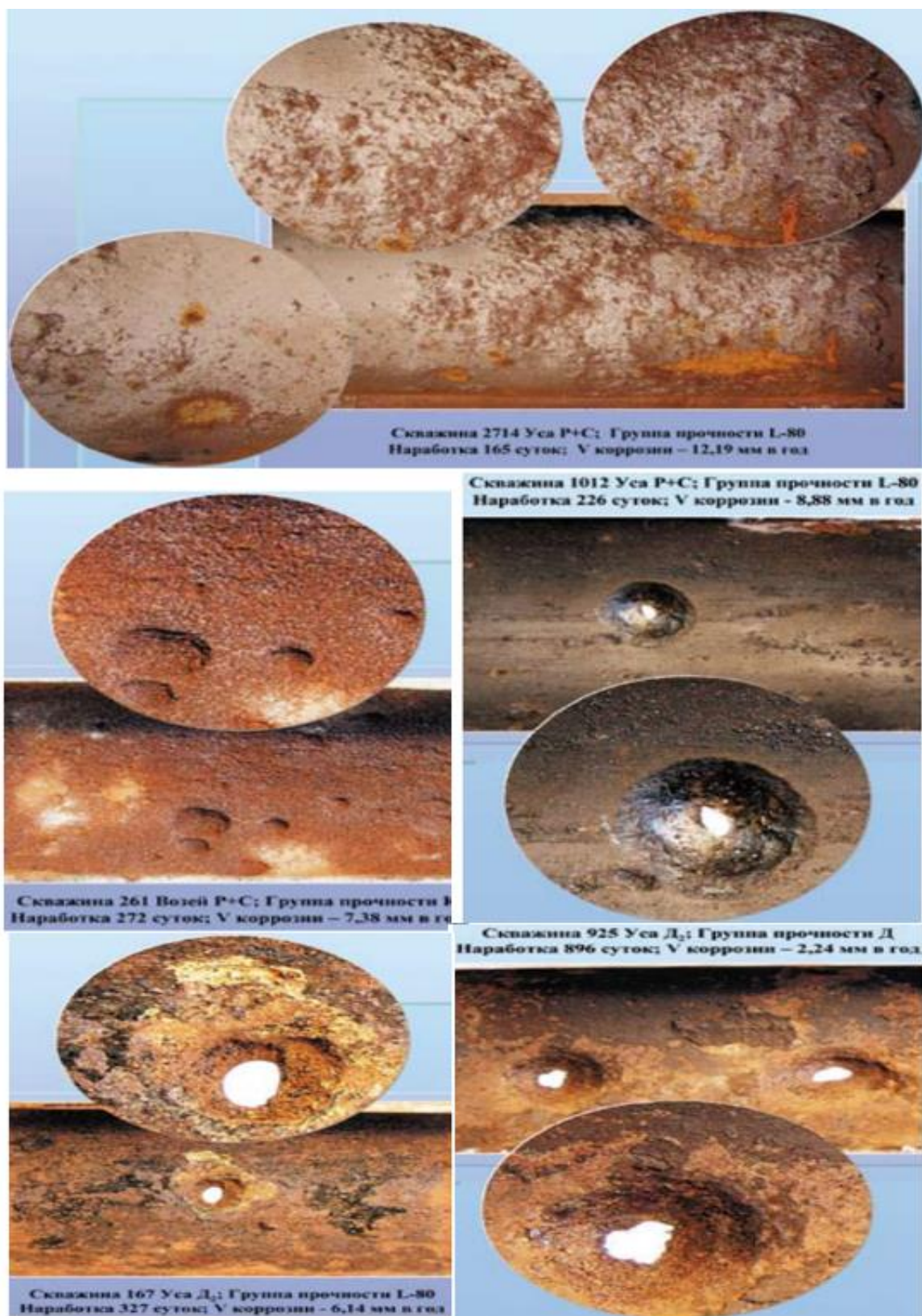
Рисунок 1.13 - Обширные язвы, глубокие питтинги, вплоть до сквозных локальных разрушений
