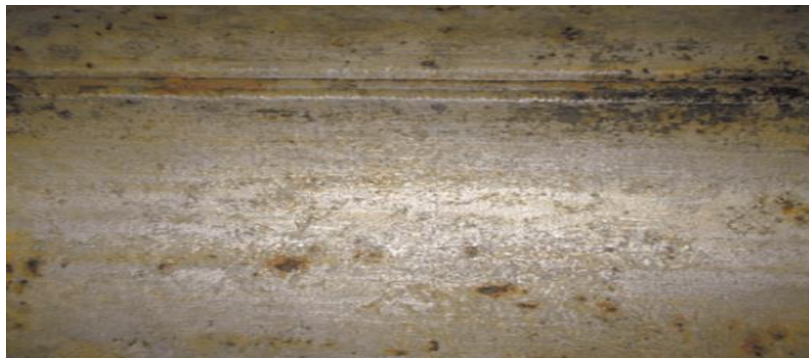
Рисунок 7 – Внутренняя поверхность трубы после эксплуатации в байпасе в течении года
