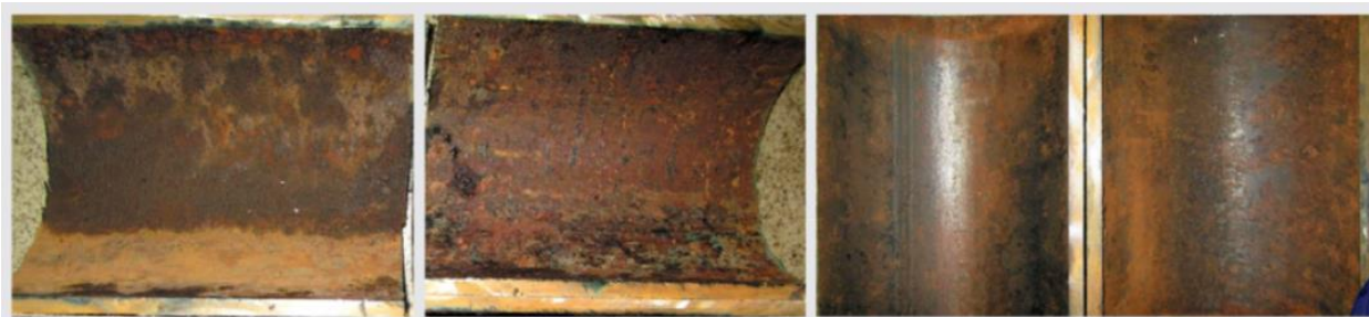
Рисунок 6 - Внешний вид фрагмента трубы после эксплуатации в байпасе в течение года
