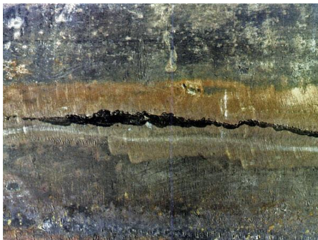
Рисунок 2 – Дефект трубопровода типа «трещина»
