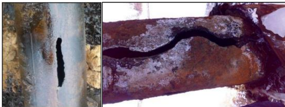
Рисунок 2 – Коррозия нефтесборного промышленного трубопровода
